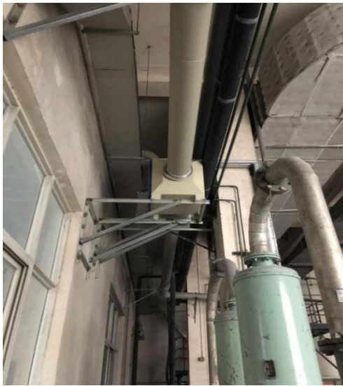
项目造粒间活性炭治理装置
