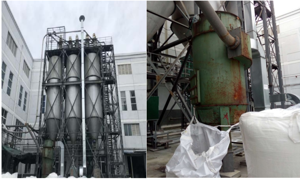
项目颗粒物排气筒项目布袋除尘
